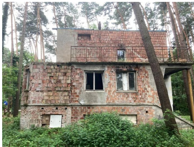
Fotografia 202. Miejsce wymagające poprawy stanu ładu przestrzennego: ulica Cicha – zniszczony budynek Fotografia własna
