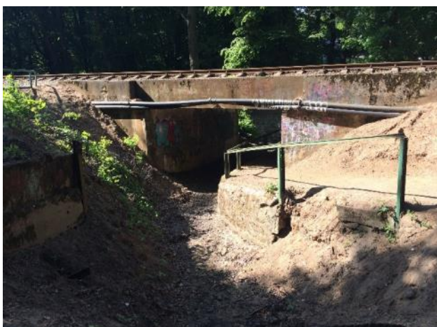
Fotografia 199. Miejsce wymagające poprawy stanu ładu przestrzennego – przejście pod torami Fotografia własna
