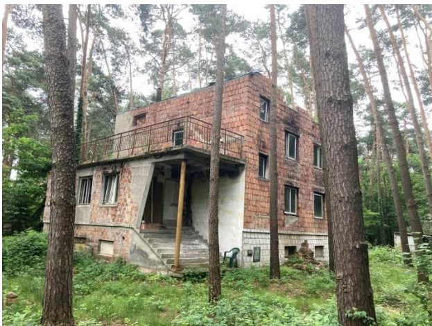
Fotografia 201. Miejsce wymagające poprawy stanu ładu przestrzennego: ulica Cicha – zniszczony budynek Fotografia własna
