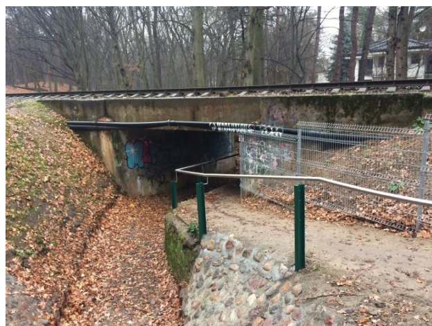
Fotografia 200. Miejsce wymagające poprawy stanu ładu przestrzennego – przejście pod torami (częściowo wyremontowane) Fotografia własna
